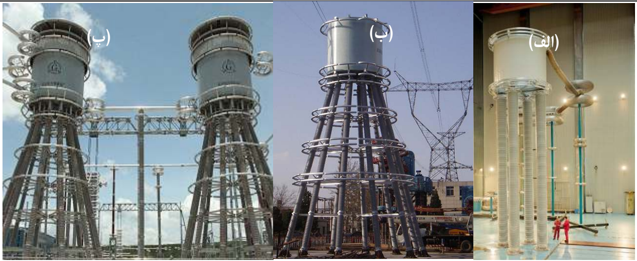
شکل ۲ راکتور هموار ساز خشک ۸۰۰ کیلوولت (الف) در حال تست در (ب) در محل سایت و (پ) راکتور CHINA ENERGY EQUIPMENT CO., LTD \pm 1100 کیلوولت ساخت شرکت (BPEG ( Beijing Power Equipment Group
