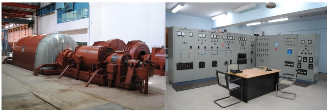
شکل ۱-۱۹: تصویر ژنراتور اتصال کوتاه ۱۵۰۰ مگاوات‌آمپر تأمین‌شده توسط Oerlikon و اتاق کنترل آن در آزمایشگاه CPRI [۹]
