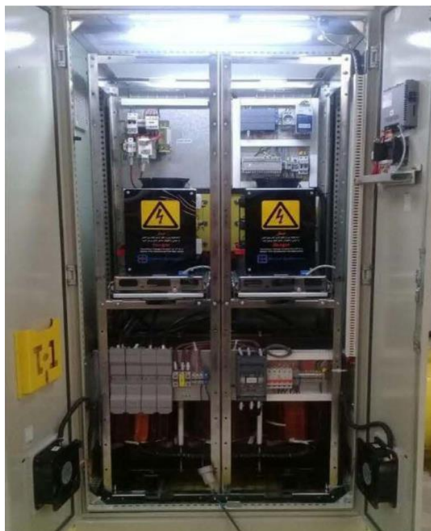
شکل ۲-۶: تصویر سیستم تحریک ۷۵ کیلوواتی ۴۰۰ آمپری ساخت شرکت اطمینان بخش
