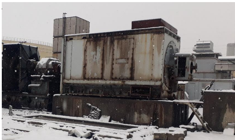
شکل ۳-۲: ژنراتور ۴۴ مگاوات آمپری ساخت شرکت آنسالدو
