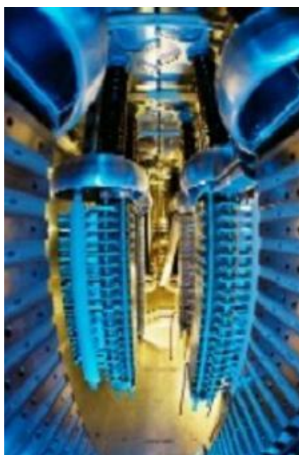
شکل (۲-۳) برج‌های تریستوری مورد استفاده در HVDC
