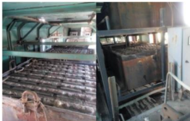
شکل ۶-۲ وضعیت حال حاضر باتری‌ها لوکوموتیو برقی هیبرید در کارخانجات بازسازی لوکوموتیو کرج
