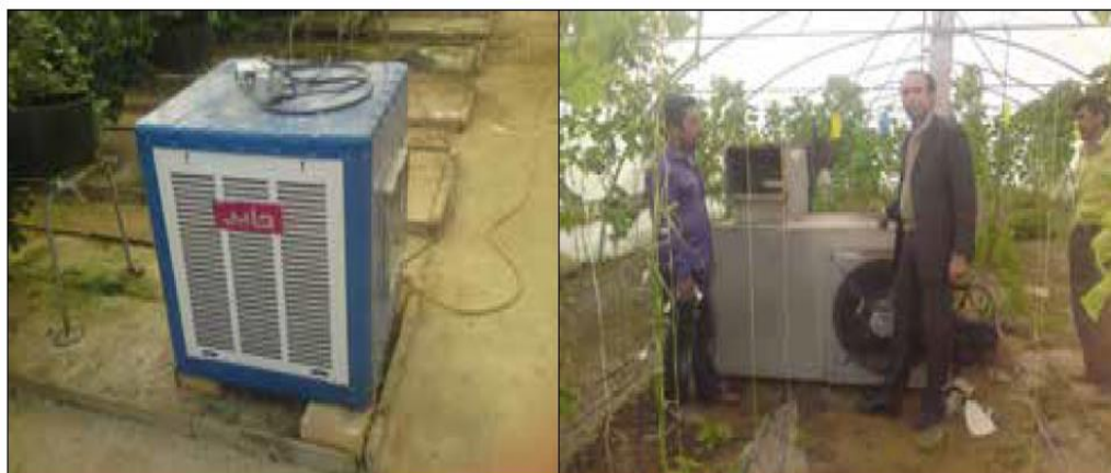
شکل ۲۶.۱ سیستم قدیمی تنظیم دمای داخل گلخانه (کولر و بخاری) [۸]
