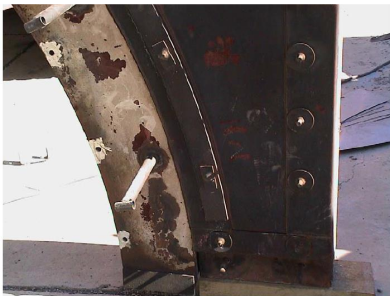
شکل ۲۳-۱. نمای اغزاست بالایی و دو عدد از ترموکوپلهای مسیر گاز داغ خروجی؛ توربین PG9161E نیروگاه منتظر قائم.
