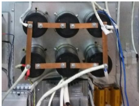
شکل ۴۰-۴: خازن‌های لینک DC، مقاومت‌های ترمز دینامیکی و مقاومت تخلیه شارژ خازن
