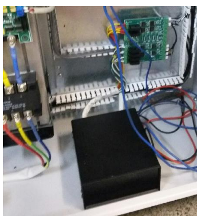
شکل ۴۴-۴: ترانسفوماتورهای برد تغذیه گیت درایو
