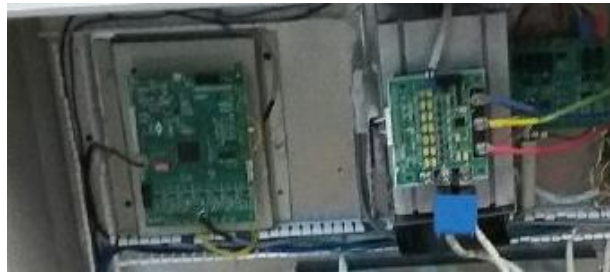
شکل ۳۸-۴: پیاده سازی ماژول اینورتر خروجی، گیت درایو و DSP آن در تابلو
