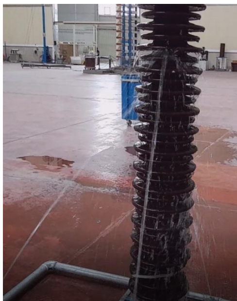
شکل (۳-۱۰): نمایی نزدیک از پاشش مناسب آب از نازل‌ها به سطح مقره
