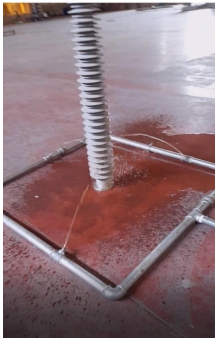
شکل (۳-۸): نمایی از وجود هوا در سیستم پمپاژ و عدم کارکرد درست خروج آب از نازل‌ها
