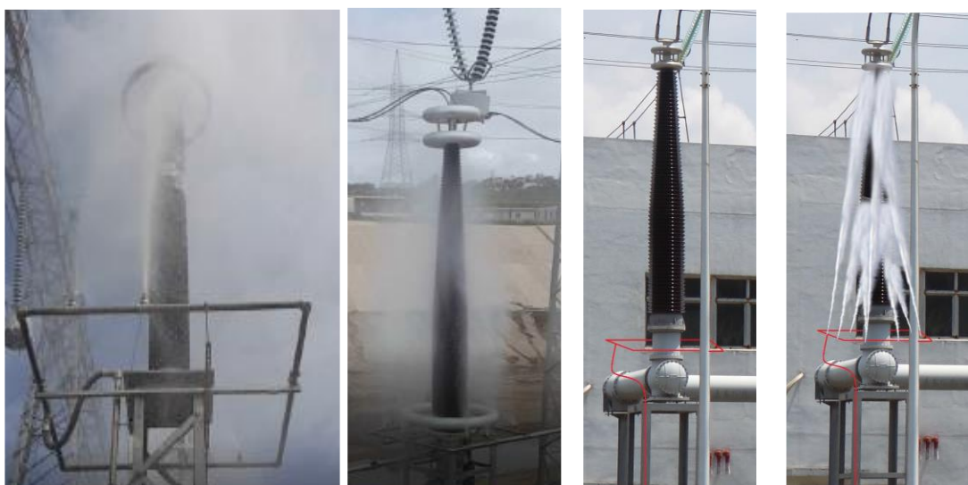
شکل (۱-۹): نمایی از سیستم آب رسانی شرکت Wilorton برای مقره پست GIS در الجزایر
