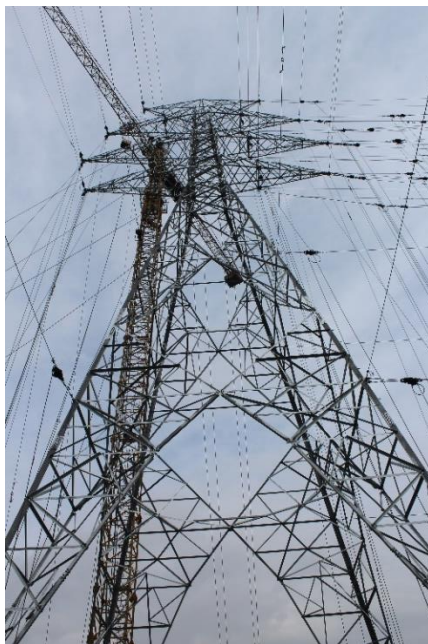
شکل ۶-۱ برج مشبک ۲۳۰ کیلوولت چهار مداره
