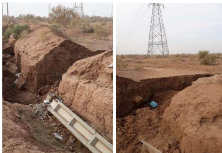
شکل ۴-۵ خرابی های دکل های انتقال نیرو ناشی از فرونشست در خط انتقال دشت اشتهارد [۱۹۲]
