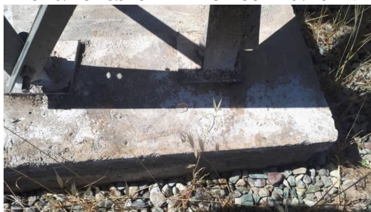
شکل ۴-۱۳- تخریب پایه های بتنی در پست درگاهان قشم
