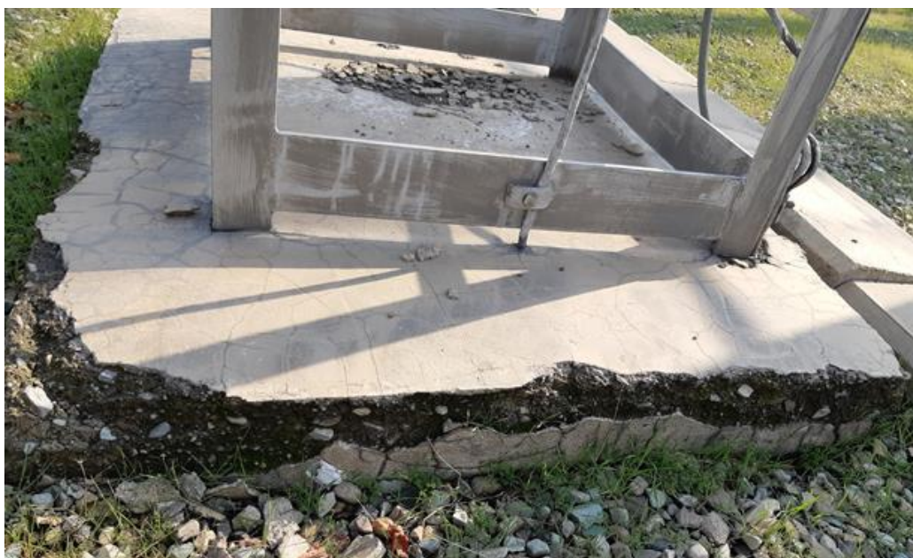
شکل ۴-۱۱- تصویر پایه بتنی تخریب شده در پست ازگل
