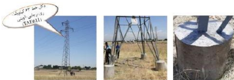
شکل ۴-۱۴- تخریب پایه های بتنی سمت غربی دکل خط ۶۳ Kv ری-رجایی-آوینی
